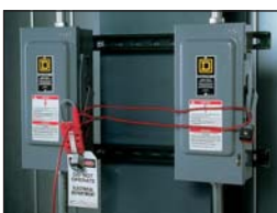
Einzelne oder mehrere Hauptschalter verriegeln
